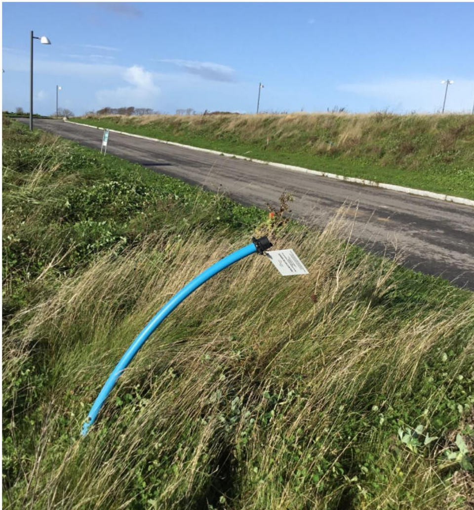
Vandstik plomberet med svejsemuffe og skilt. Plombering må kun brydes efter tilladelse fra Hjørring Vandselskab.
