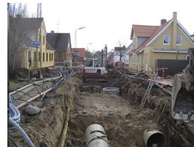
Separatkloakering i vejareal.
