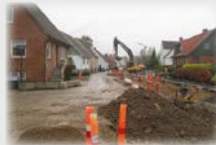
Separatkloakering i vejareal.
