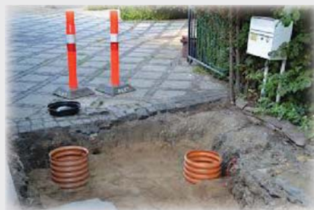
Skelbrønde til hhv. regn- og spildevand.
